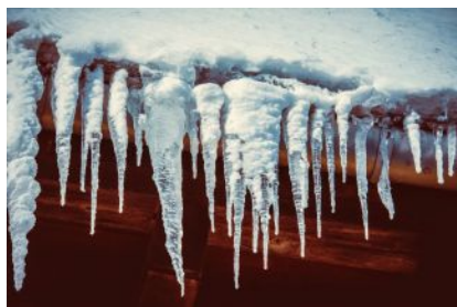
Usuwanie śniegu i sopli z obiektów budowlanych
