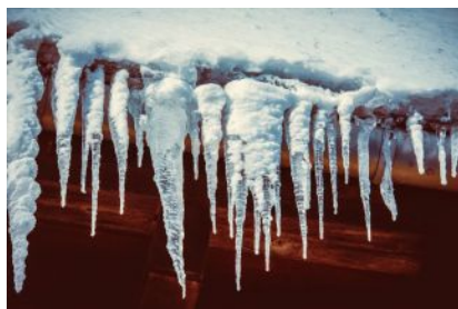
Usuwanie śniegu i sopli z obiektów budowlanych
