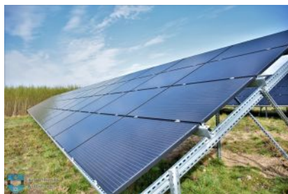
Panele słoneczne przy oczyszczalni ścieków w Kolbuszowej Dolnej
