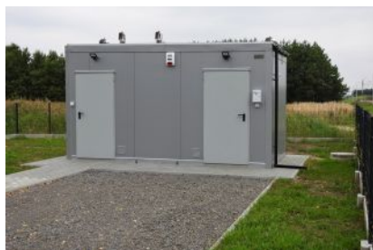
Kontenerowa stacja dezynfekcji wody w Kolbuszowej Dolnej
