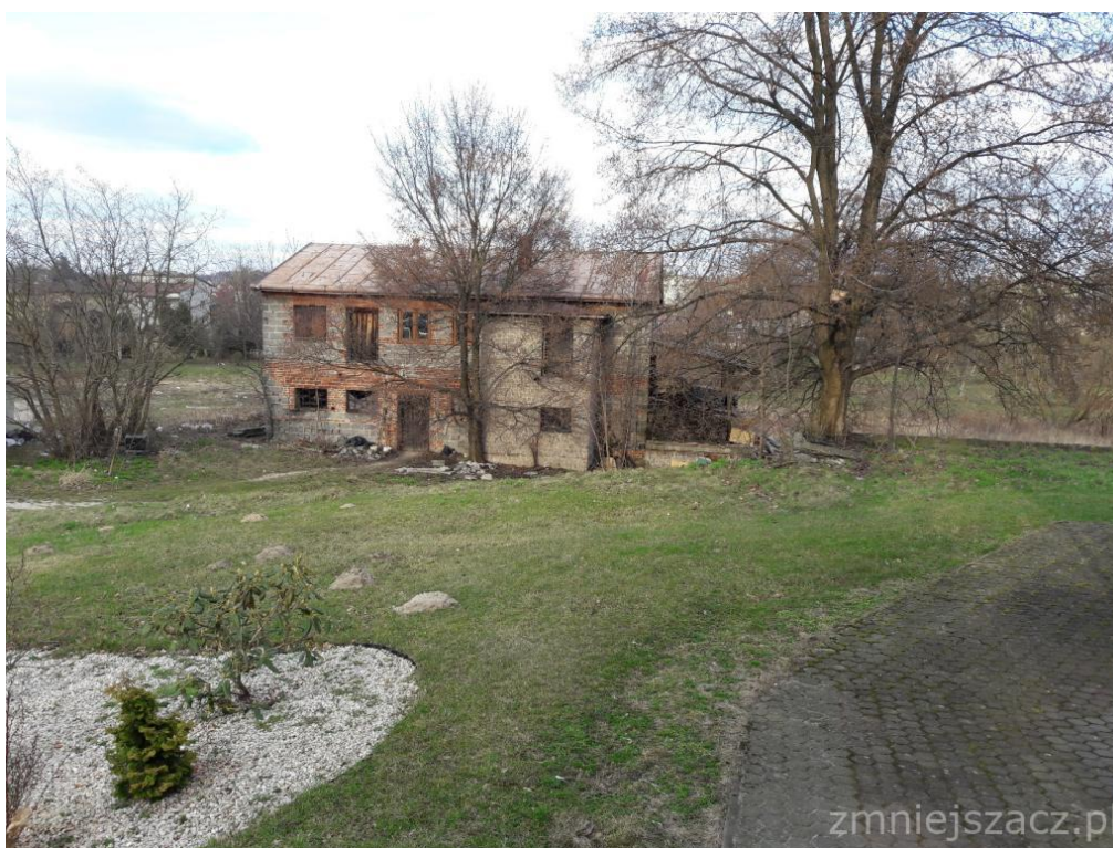
Fotografia 3 Zdegradowany budynek gospodarczy
