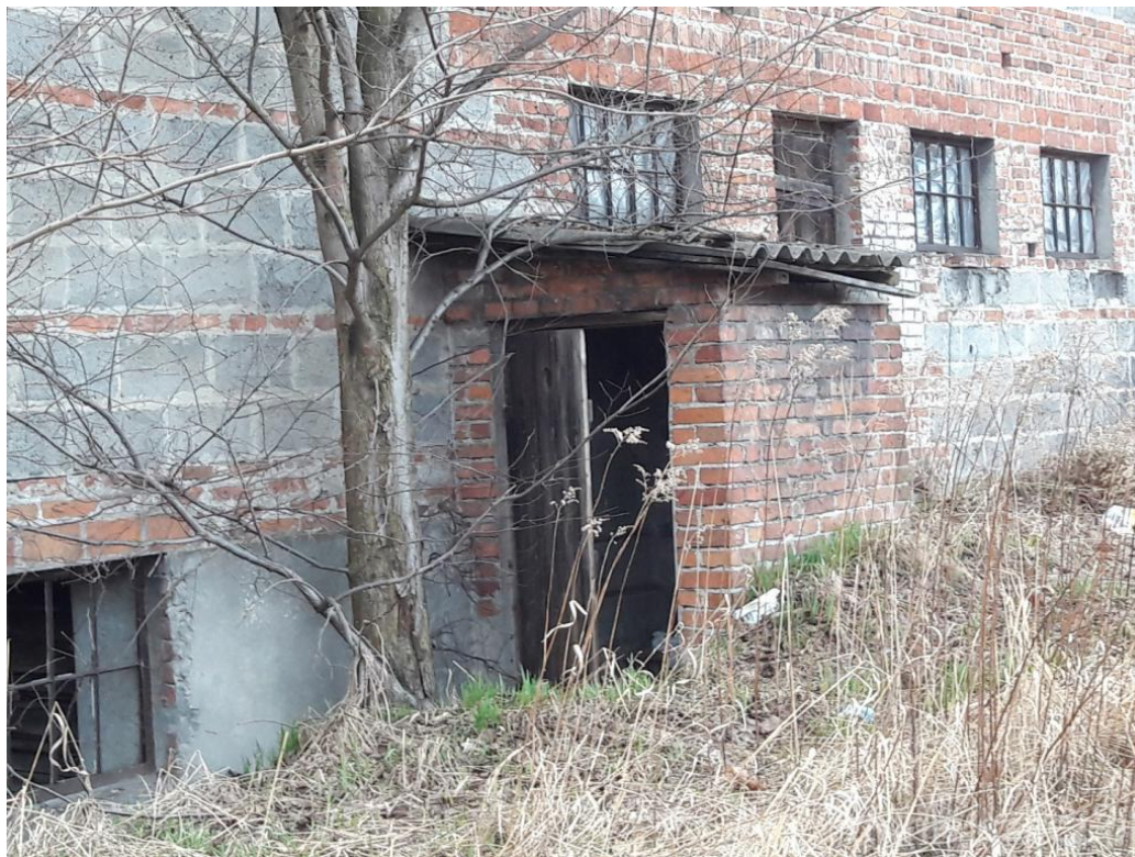
Fotografia 4 Zdegradowany budynek gospodarczy
