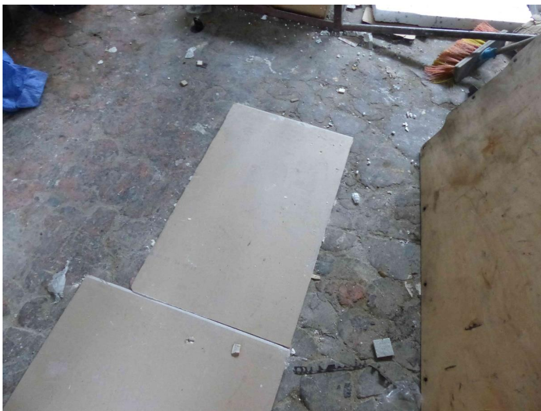
Fotografia 14 Zdegradowane pomieszczenie byłych warsztatów szkolnych
